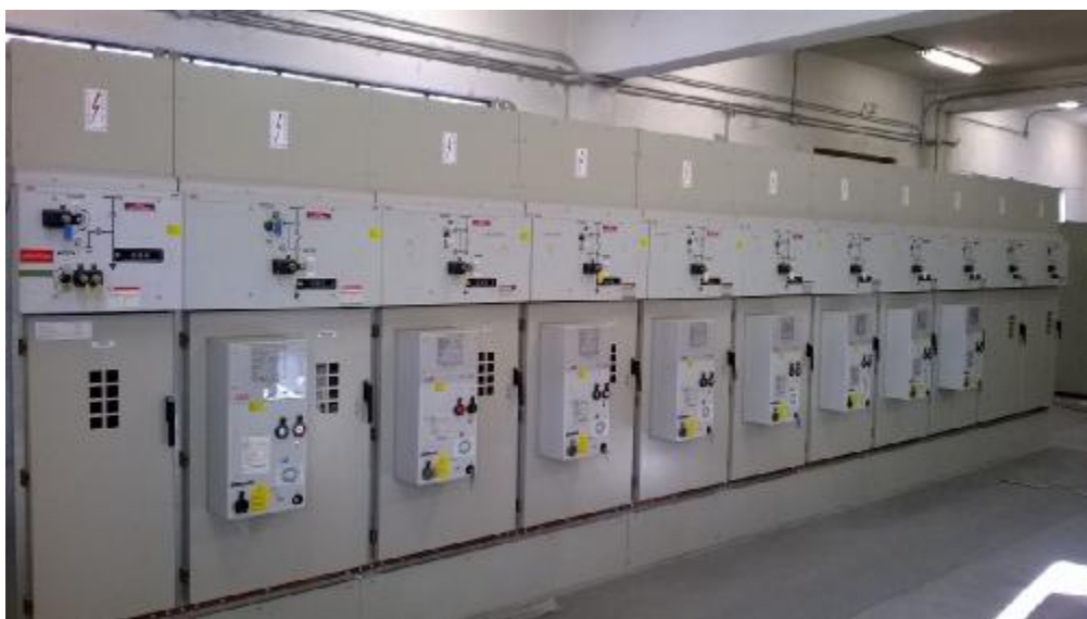
Εικόνα 4.4: Πίνακες μέσης τάσης σε υποσταθμός μέσης τάσης.
