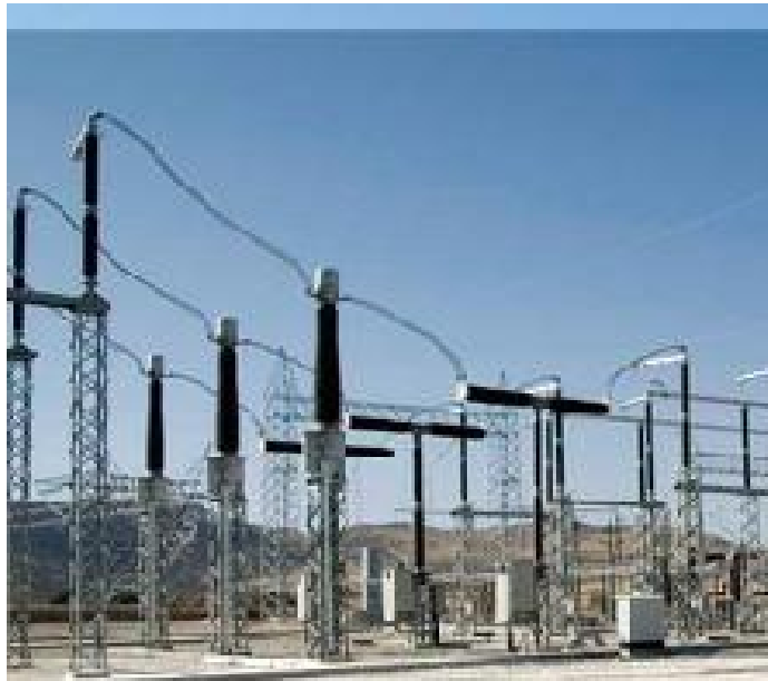
Εικόνα 4.5: Άποψη υποσταθμού υψηλής τάσης.
