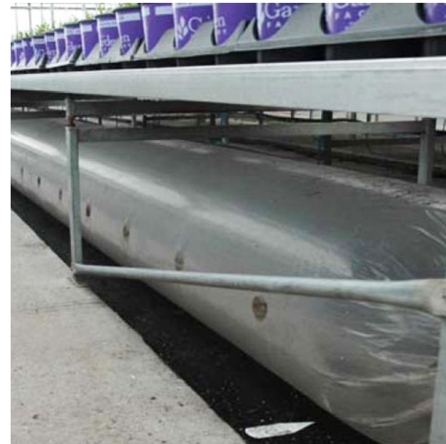
Πλαστικός σωλήνας διανομής θερμού αέρα τοποθετημένος στο δάπεδο. Οι οπές είναι πλάγια
