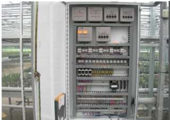
Κεντρικός Πίνακας Ελέγχου
